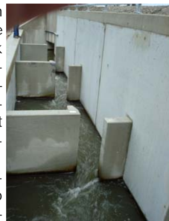
Die Fischaufstieghilfe „Vertikal-Slot“ vom Gamlitzbach in den Stauraum der Mur
